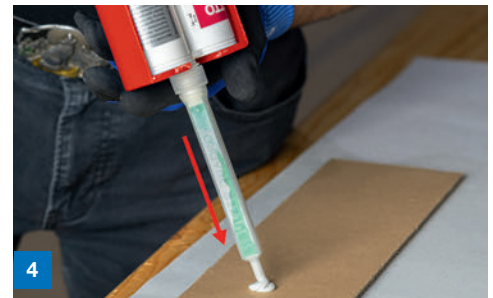
4 Den Statikmischer mit Klebstoff befüllen und Homogenität der Mischung prüfen (siehe Verarbeitungsbegleitende Qualitätskontrollen 2K-Produkte)
